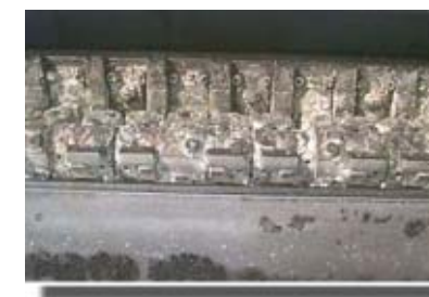
Maschine vor dem Trockeneisstrahlen
