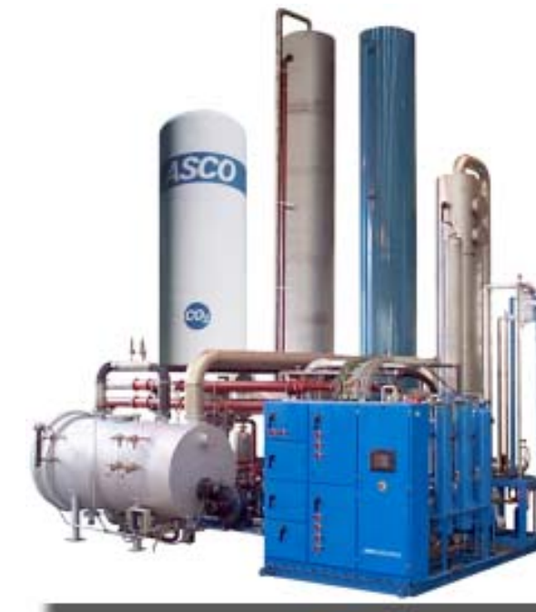
Neue automatische ASCO CO 2 Produktionsanlage
