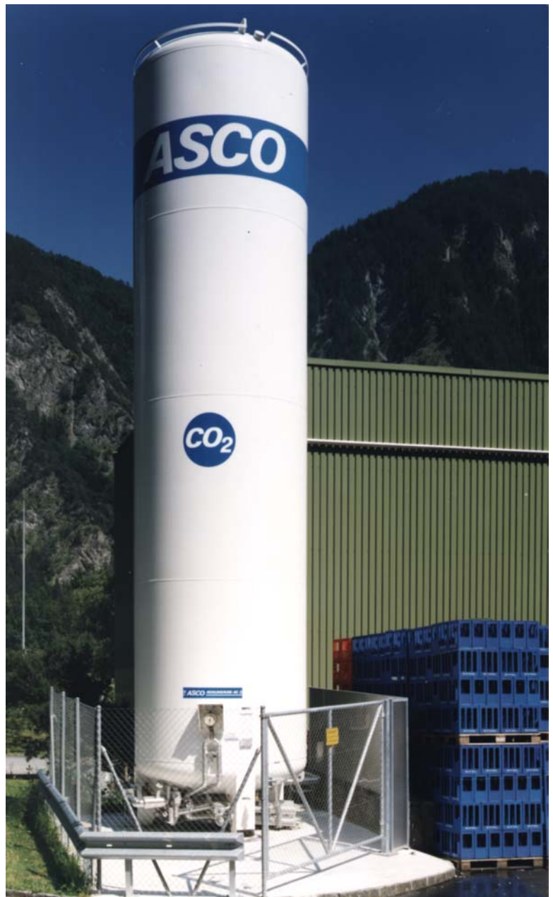
37 t vertikaler ASCO CO 2 -Lagertank, vakuum-isoliert
