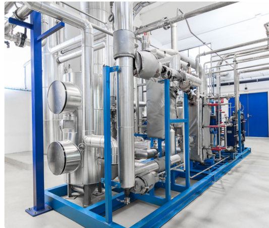
Absorber und Desorber
