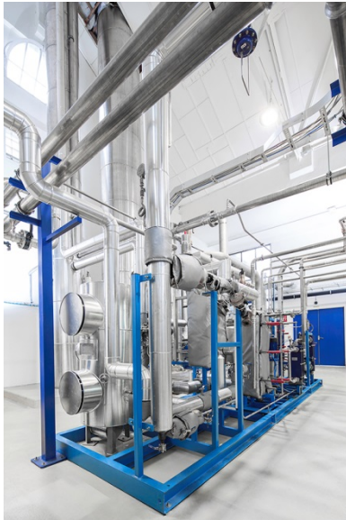
Bild 2 – 6.8 MTPD ASCO CO 2 -Rauchgas-Rückgewinnungsanlage
