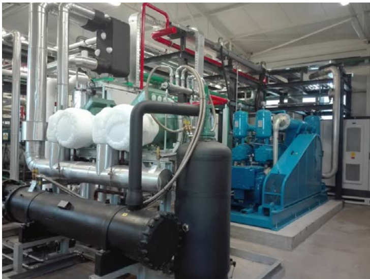
Bild 1 – ASCO CO 2 -Verflüssigungsanlage (links) und ASCO CO 2 -Verdichterstation (rechts)
