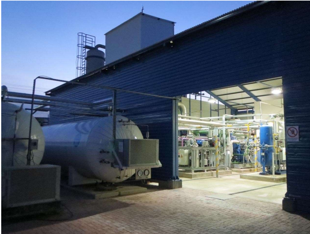
Bild 1 – CO 2 Produktionsanlage und CO 2 Lagertank
